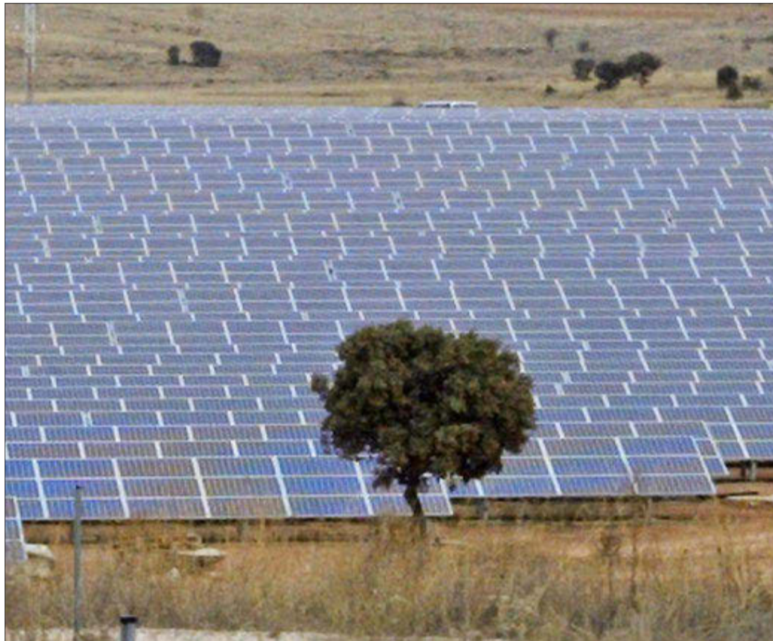
Imagen de una planta fotovoltaica en la provincia. HDS
